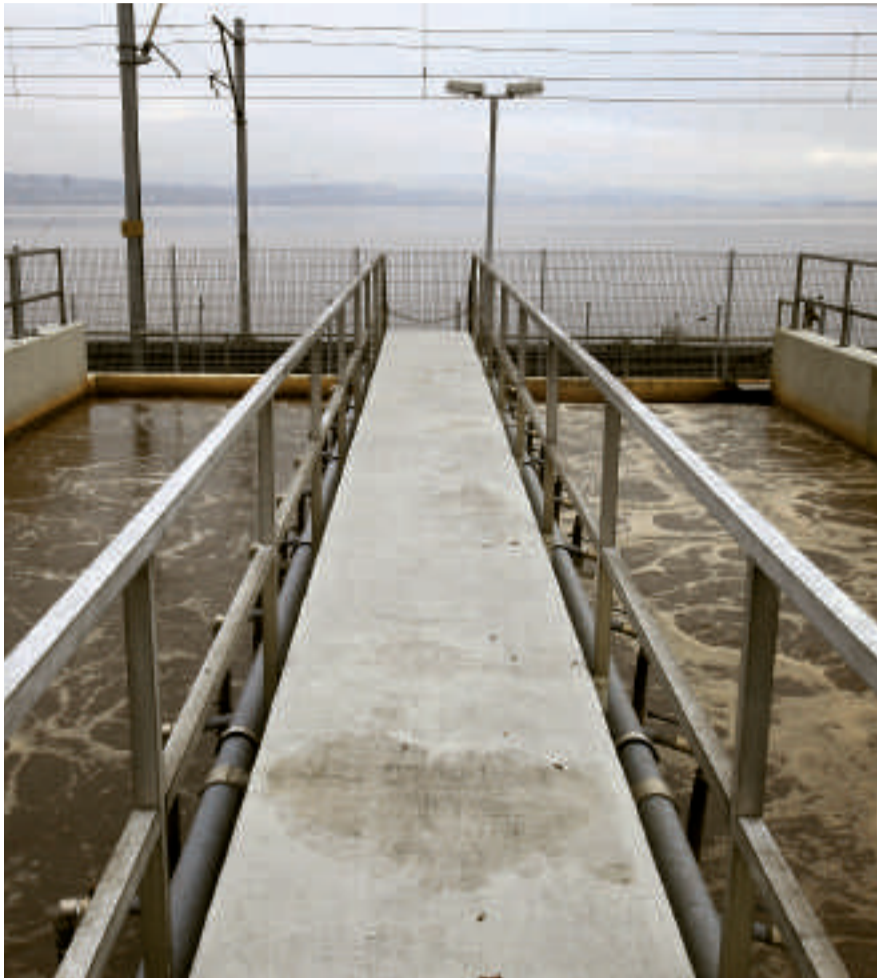
Die Kläranlage ist 23 Jahre alt und muss dringend saniert werden. Foto: S. Rock
